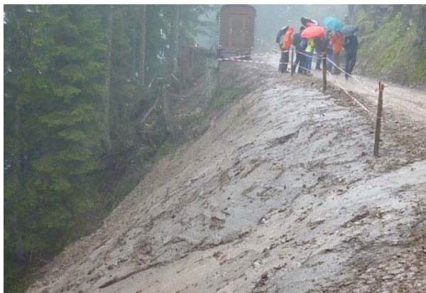
Eine Hangrutschung konnte direkt vor Ort gesichert werden mit einem Holzkasten. Dieser wurde mit Erdmaterial eingedeckt und ist nicht mehr sichtbar.
